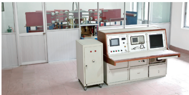
Impulse Generator hiện tại
